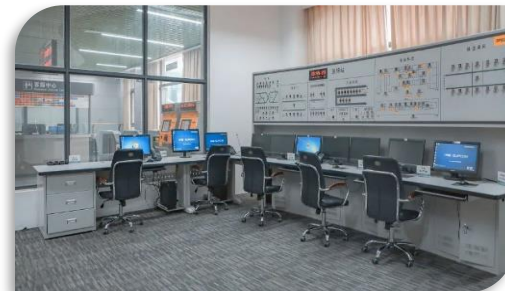
車站控制實訓室
